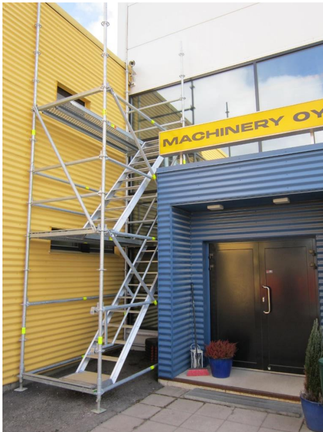
13. Kuvassa voidaan nähdä lyhyiden ja pitkien pystyvinotukien asennus 1. ritilätasolta alkaen. Kuvassa seinän vieressä ei ollut tilaa pystyvintuen asentamiseen. Vinotuki tulee asentaa jokaiseen lohkkoon, jokaiselle lyhyelle ja pitkälle seinälle.
