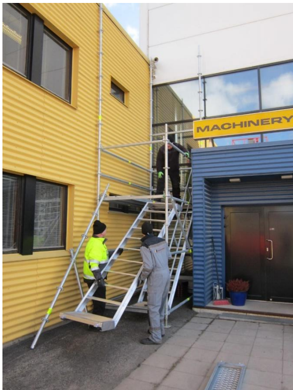
7. Tässä kuvassa tasot ovat jo paikallaan, sekä vaakajuoksut, että vaakajokat. Myös 4,0m korkeuteen on laitettu päätysivulle lyhyt U-jokka, johon voidaan laittaa seuraava porrasmous yläpäätä.
